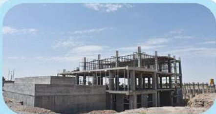
اجرای وال پست طبقه همکف - شروع آرماتوربندی سقف طبقه اول زون شرقی - خاکبرداری محوطه ضلع شمالی
