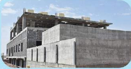
اتمام بلوک چینی دیوار پیرامونی طبقه همکف ، ضلع جنوبی - اتمام آرماتوربندی سقف طبقه اول
