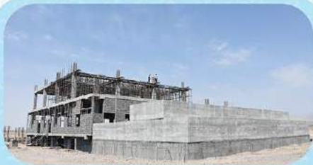
اجرای وال پست و بلوک چینی طبقه همکف شروع آرماتوربندی سقف طبقه اول زون شرقی
