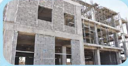
اجرای وال پست و بلوک چینی طبقه زیر زمین و طبقه همکف ضلع شمالی - آرماتوربندی سقف طبقه اول زون شرقی
