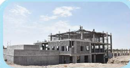
بلوک چینی طبقه همکف ضلع شمالی و شرقی - اجرای آرماتوربندی تیرهای اصلی سقف طبقه اول زون شرقی
