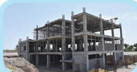
ادامه آرماتوربندی سقف طبقه اول - بلوک چینی ضلع غربی دیوار پیرامونی طبقه همکف - اجرای وال پست ضلع شمالی طبقه همکف
