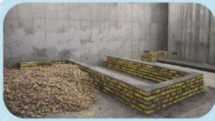
اجرای پیت دستگاه رادیوترابی داخل بونکر
