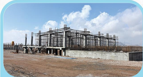
آرما تور بندی تیر های سقف طبقه اول (آزمایشگاه و کلینیک تخصصی)
