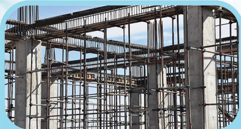
آرما تور بندی تیر های سقف طبقه اول (آزمایشگاه و کلینیک تخصصی)
