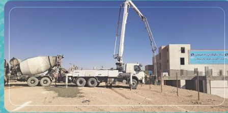
بتن‌ریزی فنداسیون دیوار حائل زون غربی و گودال باغچه شمالی (محوطه موتورخانه)
