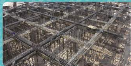
اجرای آرماتوربندی تیرهای اصلی و فرعی سقف اول زون مرکزی مرحله اول
