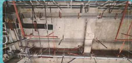
ادامه اجرای تأسیسات زیر سقف زیرزمین زون شرقی و شروع لوله‌گذاری برق
