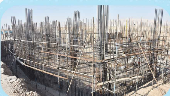
تکمیل آرماتوربندی ستون‌ها، دیواربرشی و اجرای داربست ضلع جنوبی طبقه زیرزمین زون مرکزی
